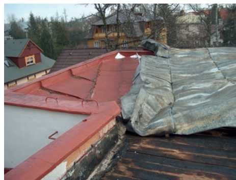
Stav oceľovej strešnej krytiny po päťdesiatich rokoch.
